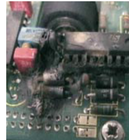
Schaden an Elektronik durch blitzbedingte Überspannungen
